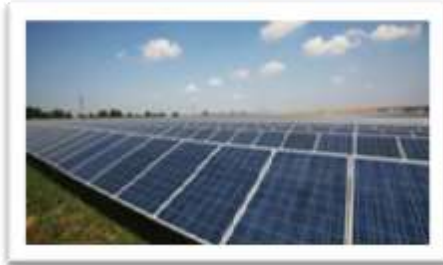
Солнечная ЭС мощностью 40 МВт Сибирь
