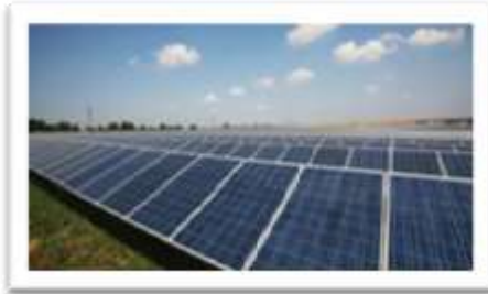
Гибридная солнечная электростанция Общая мощность 95 МВт Южная Россия/Чёрное море
