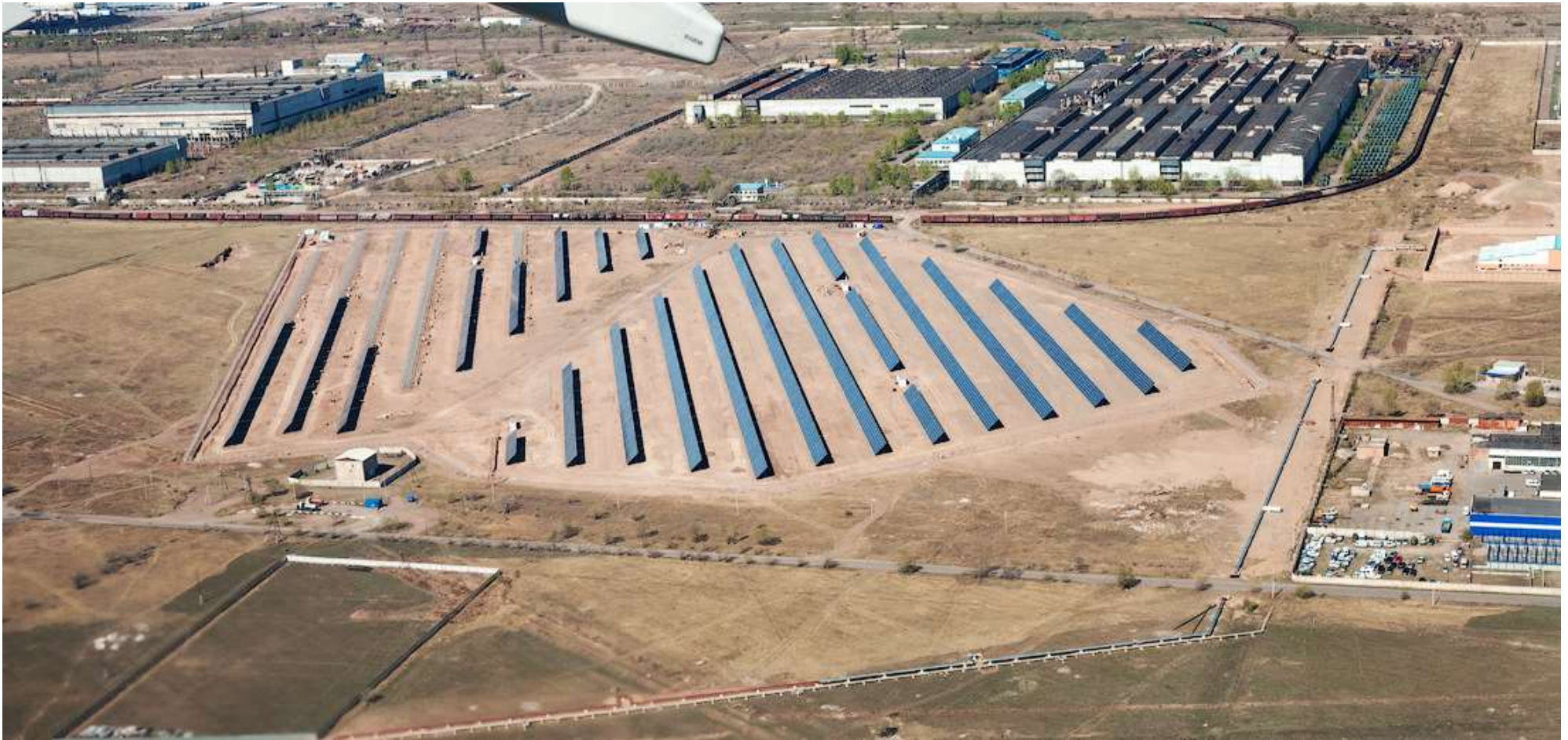
Сибирь — Солнечная электростанция мощностью 5 МВт введена в эксплуатацию в декабре 2015 г. Ведутся работы по увеличению мощностей до 40 МВт.
